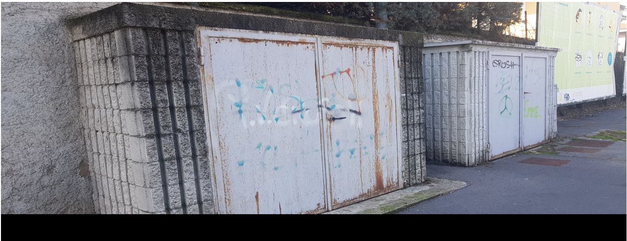
Muro del Palazzetto dello Sport, lungo la via che dalla rotonda di Via XXV Aprile conduce a Vicolo Stretto - muro mostra
