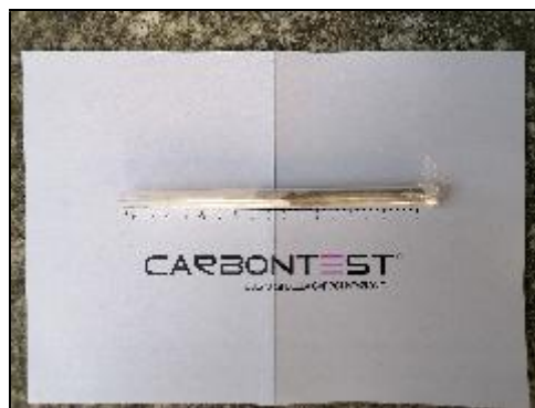
Foto 8.2 - Particolare carbonatazione - Trave Edificio 4
