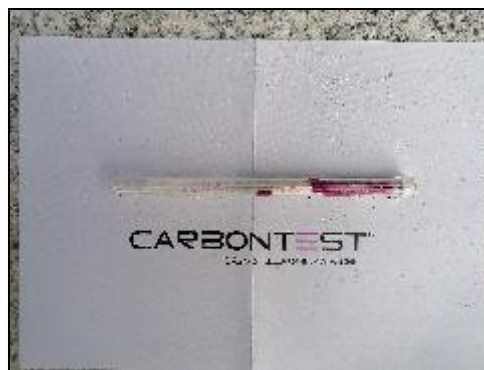
Foto 7.2 - Particolare carbonatazione - Pilastro Edificio 3
