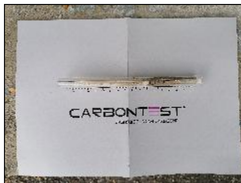
Foto 1.2 - Particolare carbonatazione - Pilastro Edificio 1
