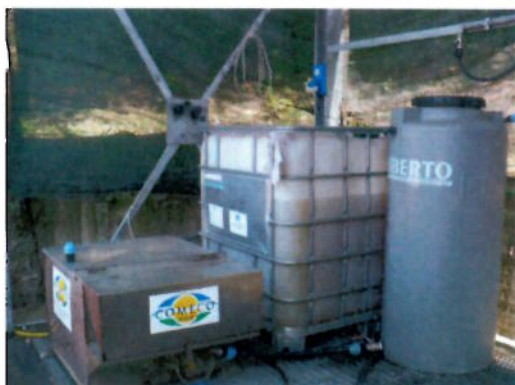
Impianto di distribuzione
