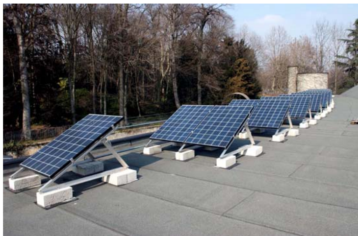
I pannelli solari collocati sul tetto dell'Ufficio tecnico
