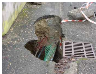
Rottura del manto stradale
