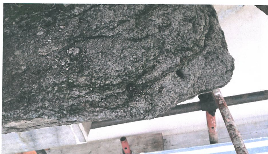
Foto 6, 7, 8 : Lo stato di degrado della pietra sullo spigolo destra del balcone, in cui la ricostruzione cementizia è stata espulsa (si vedono le vecchie forature per i perni di ricostruzione).
