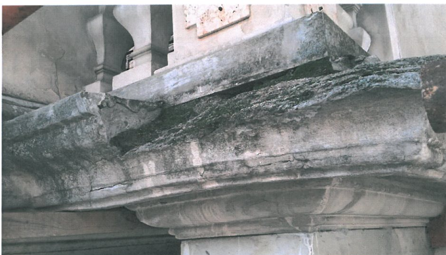
Foto 2, 3, 4, 5 : Le ricostruzioni cementizie del balcone e la cattiva conservazione della pietra.
