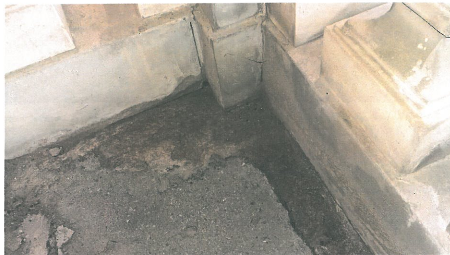
Foto 9 : L'interno del balcone, in corrispondenza allo spigolo esterno fortemente ammalorato. Si vede lo strato impermeabile grigio che ricopre ormai in modo poco omogeneo la superficie della pietra. Al di sotto di questo la pietra appariva disgregata ed umida.
