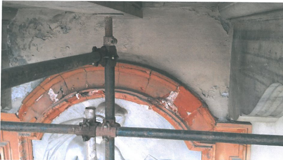
Foto 1 : porzioni murarie e decorazioni sotto al balcone, caratterizzate da notevole degrado materico.
